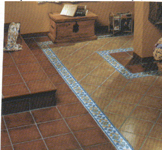
Figura XVIII.5 – Pavimento com revestimento cerâmico
