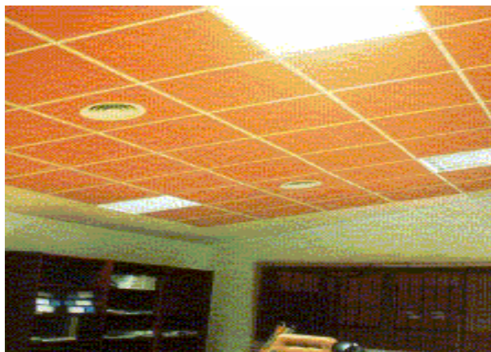
Figura XVI.22 – Tecto com painéis em lâ de rocha.
