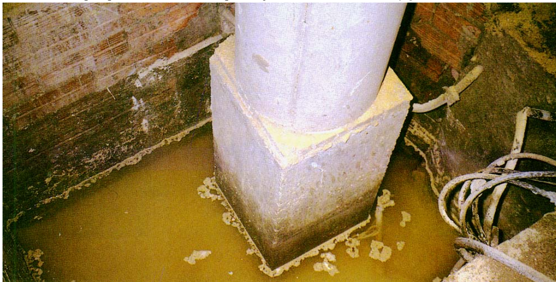
Figura XIII.3 – Excesso da água em pavimento por inexistência ou deficiente funcionamento do sistema de drenagem
